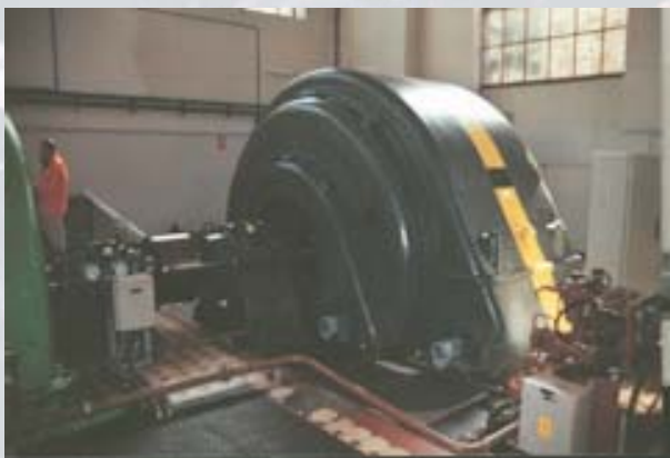
Grup generador de la central de Cabdella
